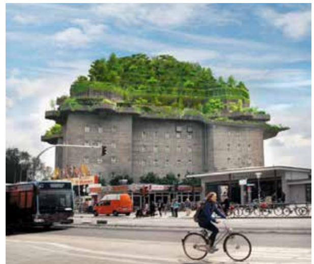
Umstritten – aber inzwischen haben die Bauarbeiten zur Dachbegrünung begonnen: Daher müssen die beliebten Führungen über den Hochbunker Feldstraße in diesem Jahr ausfallen
